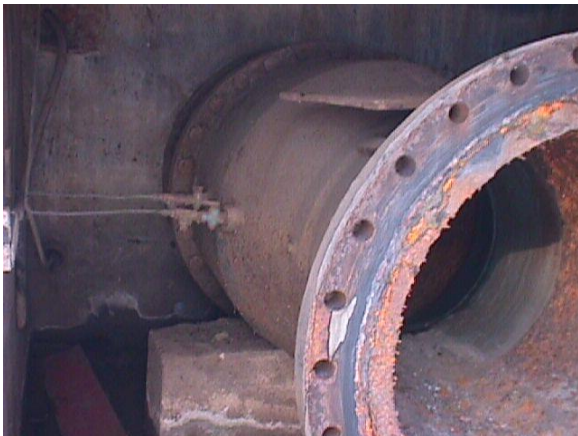
Рис. 1. Характерний вигляд труби великого діаметра, що тривалий час перебувала в експлуатації
