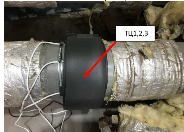
Рис. 4. Накладні термометри в котельні на трубопроводі DN150
