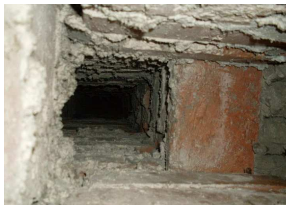
Рис. 1. Вентиляційна шахта з наявними перешкодами
